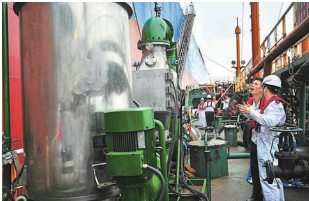
■工作人員仔細檢查駁船上的壓載水處理設備。香港文匯報深圳傳真
