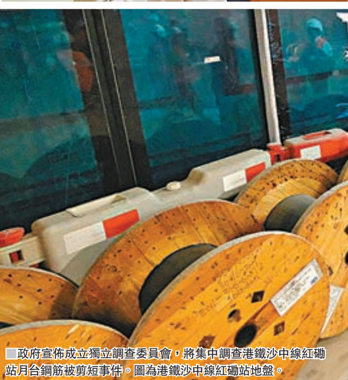
政府宣佈成立獨立調查委員會，將集中調查港鐵沙中線紅磡站月台鋼筋被剪短事件。圖為港鐵沙中線紅磡站地盤。
