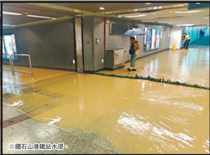
■鑽石山港鐵站水浸。
