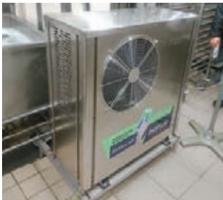
■熱泵不單節能，亦能改善員工工作環境。醫管局供圖
