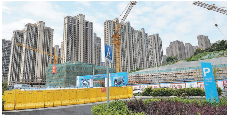
昨日《房地產藍皮書(2018)》發佈,藍皮書稱,2018年將成中國本輪房地產市場低點,預計房地產價格全年平穩回落。圖為福建福州市區一處正在建設中的樓盤。中新社
