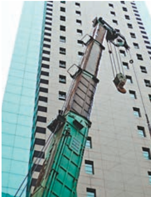
■公署調查發現，路政署及勞工處對吊運安全的要求不同，認為兩個部門溝通嚴重不足。
