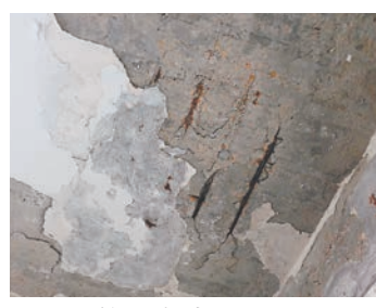
重建範圍內樓宇大多日久失修, 鋼筋外露嚴重。香港文匯報記者岑志剛 攝
