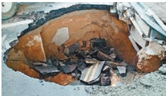
通州街路陷，出現3米深坑窿。
