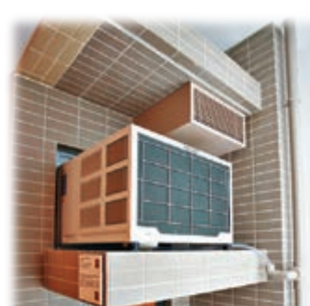
■冷氣機喉管在室外或牽涉公用地方，破壞公用地方要由住戶負責，成為維修時的隱藏費用。
