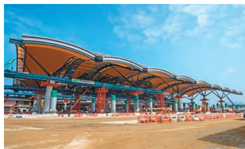
圖為攝於2016年年底的正在興建的旅檢大樓。採用了橫向液壓推進系統,把天幕組件逐一安裝在大樓設計的位置上。
