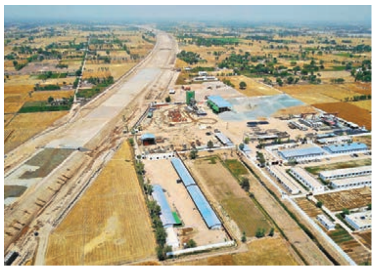
■巴基斯坦白沙瓦至卡拉奇高速公路,中巴經濟走廊最大的交通基礎設施項目已現雛形。資料圖片
