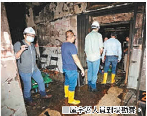
屋宇署人員到場勘察。
