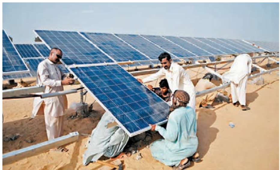
周林生表示，將加大對企業在「一帶一路」沿線重大基礎設施建設項目的生態環保服務與支持。圖為國開行牽頭支持、中興能源在巴基斯坦旁遮普省建設的900兆瓦太陽能地面電站。
