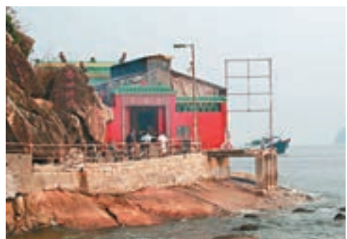
馬環村天后廟旁有構築物被颶風吹毀，只剩下鐵架和地基。 香港文匯報記者彭子文 攝
