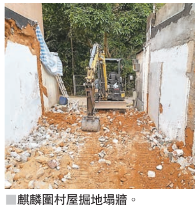
麒麟圍村屋掘地塌牆。
