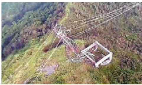
■和平電廠輸電鐵塔因颱風倒塌。 中央社
