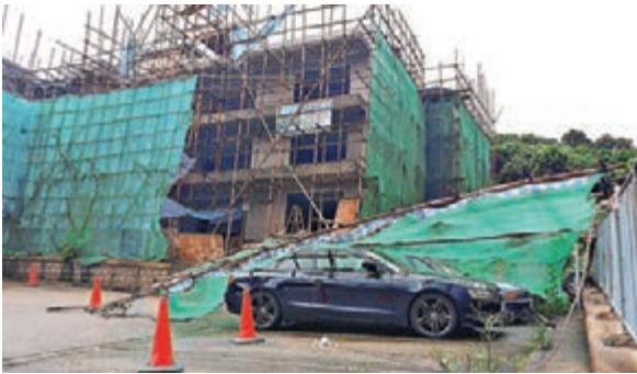
■村屋棚架塌下壓中兩輛私家車。
