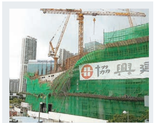
強風襲棚架 天氣不穩間中有狂風驟雨,東涌達東路一個建築地盤,其中一幅約50米乘20米的棚架,昨晨10時20分疑不敵強風吹襲鬆脫傾斜,搖搖欲墜,街坊恐隨時塌下,報警求助。消防及警方接報派員到場了解,將現場達東路一段行車線臨時封閉,並通知地盤負責人派員進行搶修加固。 ■香港文匯報記者 杜法祖
