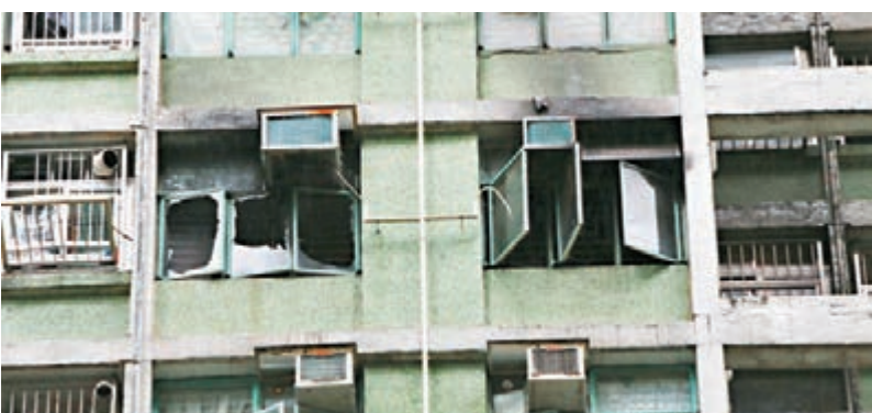
抽濕機起火單位門窗被燒穿。香港文匯報記者鄧偉明攝
