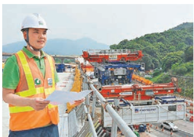
蓮塘/香園圍口岸連接路的粉嶺公路交匯處，橫跨粉嶺公路和港鐵東鐵線。
