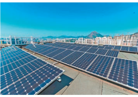
裝置於藍田邨天台的太陽能光伏系統。
