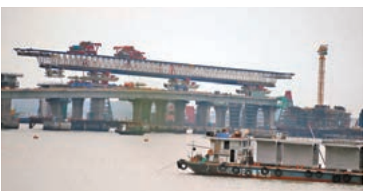
港珠澳大橋香港段上月底發生兩死三傷工業意外。資料圖片
