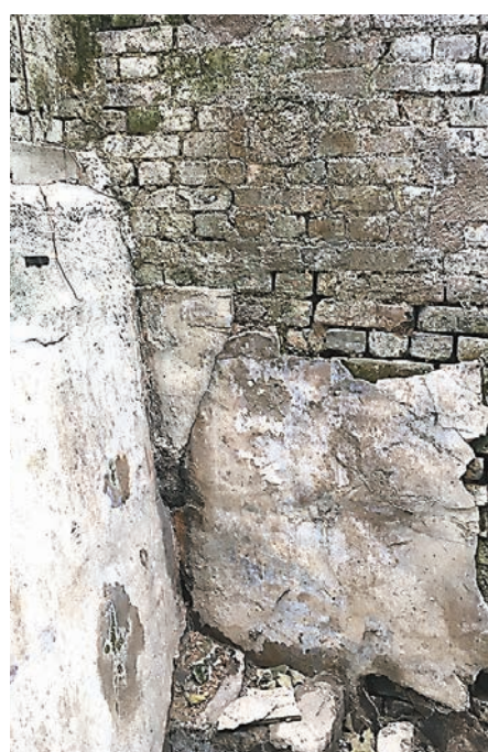
■新方案建議將閣麟街的中間地段改建為行人通道。現場可見,下部分牆身被塗上混凝土。 翁麗娜 攝
