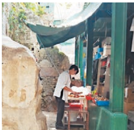
青磚牆現時被用作「廚房後欄」，牆身破落。
