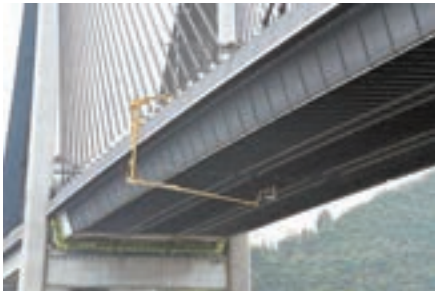
■汲水門大橋被躉船吊臂撞毀橋底，事後須封橋檢查及搶修。 資料圖片
