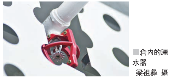
倉內的灑水器。 梁祖彝 攝
