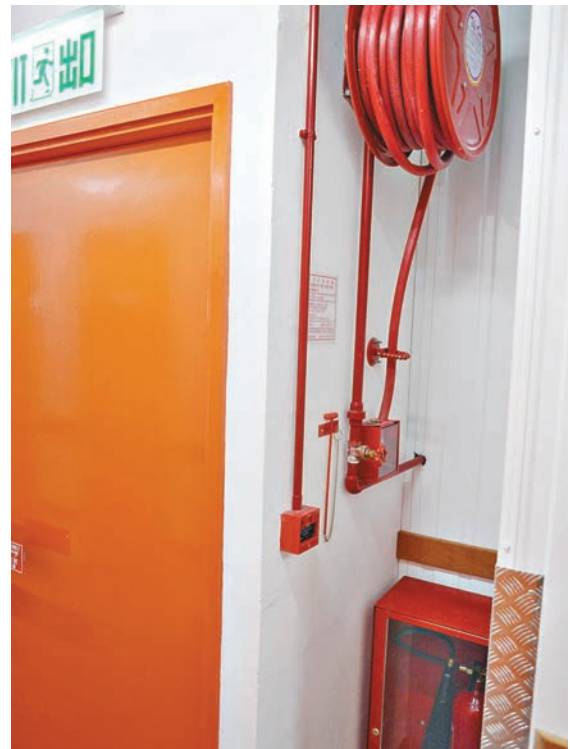
倉內的消防喉及滅火筒。 梁祖彝 攝
