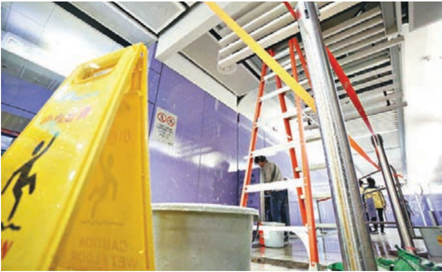
港鐵職員爬梯拆開假天花，證實頂部消防喉水管導致水浸。
