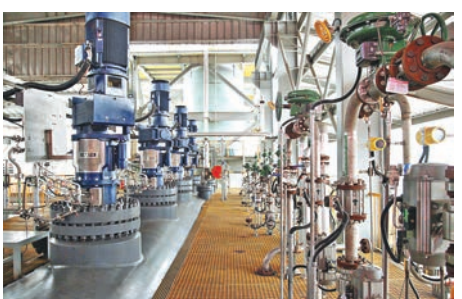
■紫金礦業日前建成投用的「加壓預氧化」系統裝置。
