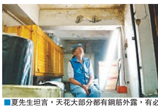
夏先生坦言,天花大部分都有鋼筋外露,有必要重建。梁祖彝攝
