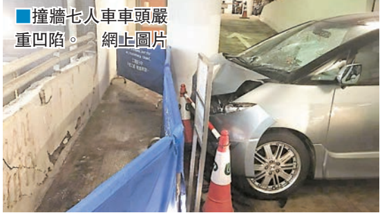
撞牆七人車車頭嚴重凹陷。網止圖片 香港文匯報訊(記者 杜法祖)馬鞍山恆安邨停車場昨午上演汽車撞穿圍牆險告墜樓情節,一輛七人車先高速失控撞向圍牆,牆身應聲毀爛,欄杆變形彎曲,幸圍牆夠堅固未致倒塌,七人車車頭嚴重凹陷,未有彈出樓層,司機飽受驚嚇,報稱胸痛送院檢查。據悉今年已先後發生5宗同類汽車撞毀停車場圍牆甚至墜樓事故(見表),4名司機因而受傷。
