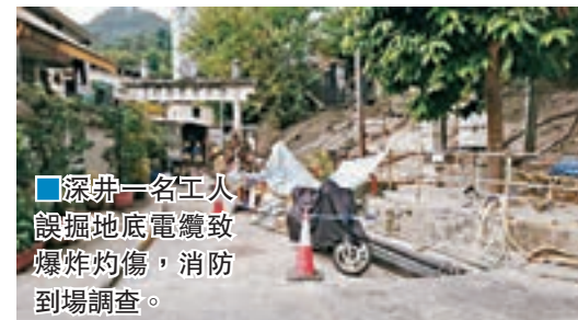
深井一名工人誤掘地底電纜致爆炸灼傷，消防到場調查。
