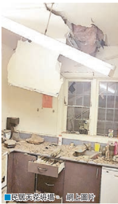
■民居天花坍塌。 網上圖片
