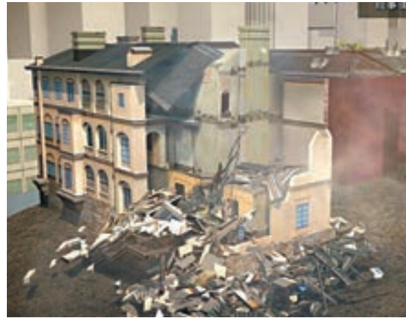
■檢討結果指北面牆進行挖孔工程，加上涉事結構的西邊窗台托臂出現沉降，最終導致北牆及部分西牆倒塌。岑志剛 攝
