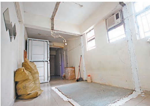
■單位內部仍未裝修完畢，電線外露掛在半空。
