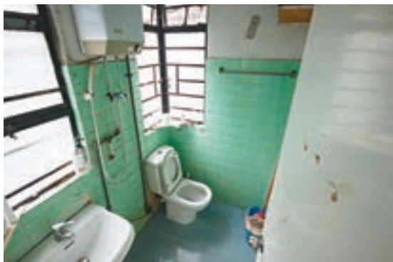
■洗手間浴室設備陳舊。
