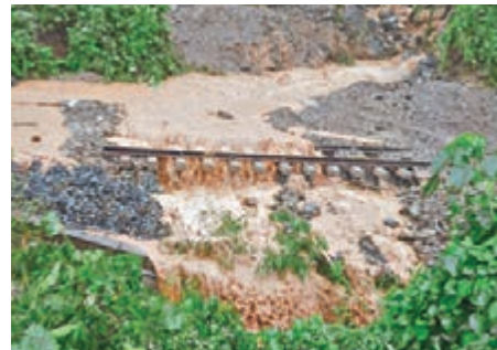
大雨導致台鐵南迴線太麻里路段路基流失，台鐵無法通行。
