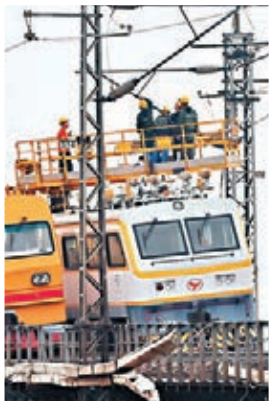
廈門鐵路供電設備受損嚴重，廈門站停運。鐵路局工人趕緊修復供電設備，清理路障。 新華社
