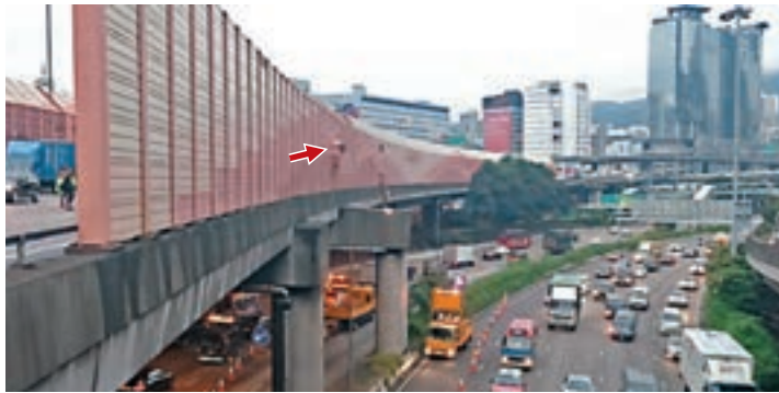
橋面隔音屏被洞穿，碎片飛墜橋下葵涌道，警方須封路清理。
