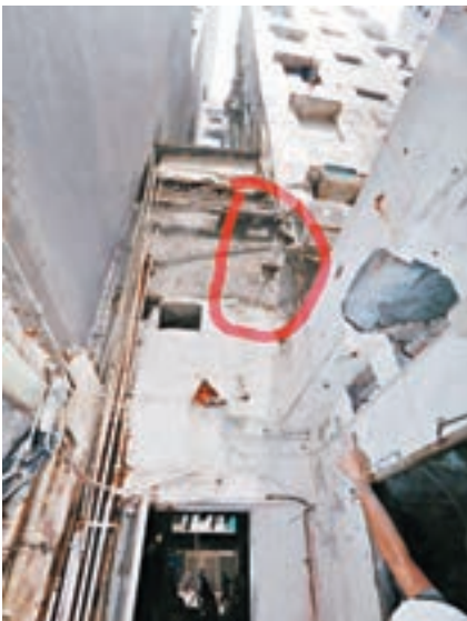
■住客指地下至2樓的外牆銅喉又被偷去。 鄧偉明 攝
