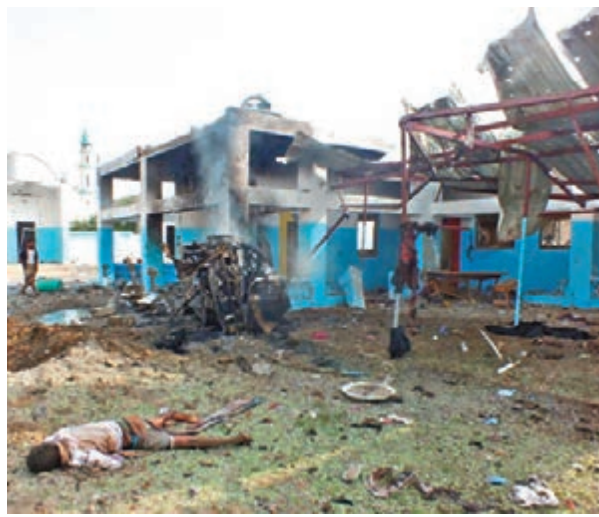
空襲造成傷亡，醫院建築物損毀。路透社
