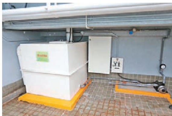
■中華煤氣在大樓天台設置一立方米的雨水收集缸,用以灌溉和清潔。
