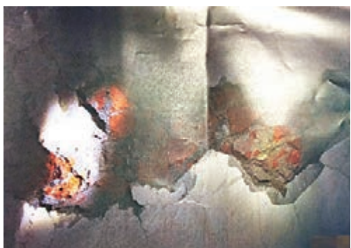
■牆壁剝落，但仍包裹鋼筋。
