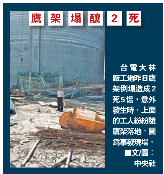
台電大林廠工地昨日鷹架倒塌造成2死5傷，意外發生時，上面的工人紛紛隨鷹架落地。圖為事發現場。
