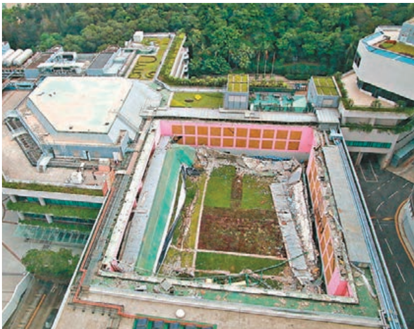
■ 劉秀成指屋頂跌下增加下層承重壓力，建議城大盡快清理。
