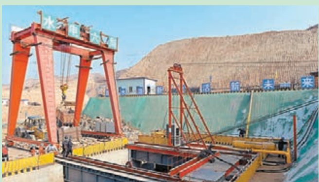
■蘭州市第二水源地項目位於臨夏州東鄉縣的1號支洞施工現場。
