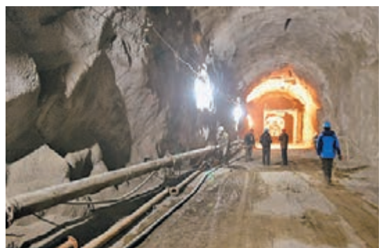
■臨夏州永靖縣的蘭州市第二水源地項目5號支洞內，工人在檢查管線鋪設情況。
