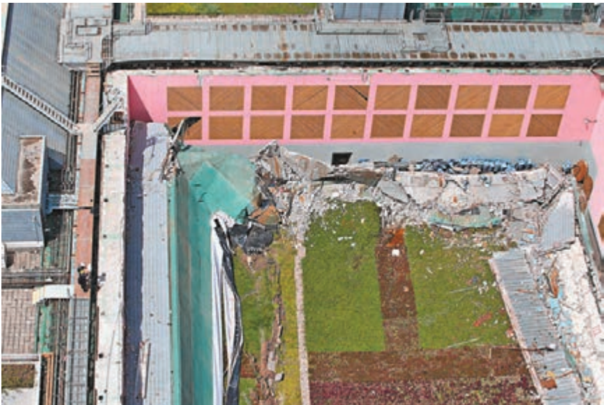
■發生倒塌的會堂至今仍未解封，現場堆積大量坍塌石屎、瓦礫、鋼筋、斷裂支架等，兩名工程人員到場視察。
