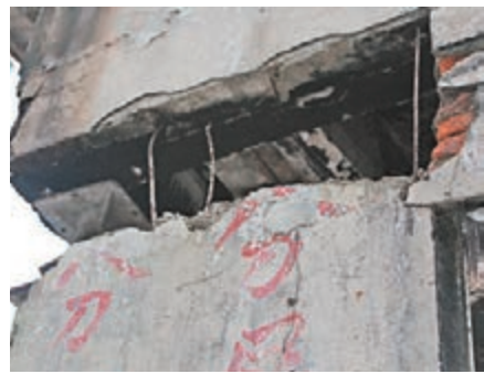
牆身有石屎剝落及鋼筋外露。 莊禮傑 攝
