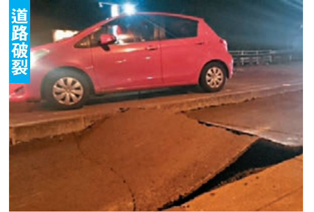
益城町有道路破裂。
