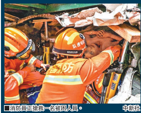
■救援人員在坍塌現場進行救援。 新華社
