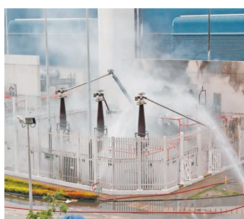
■ 中電龍鼓灘發電廠一個變壓器組疑遭雷電劈中爆炸起火,消防拖喉射水灌救。
