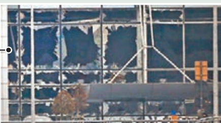
爆炸威力強大，把機場窗戶震碎。路透社
